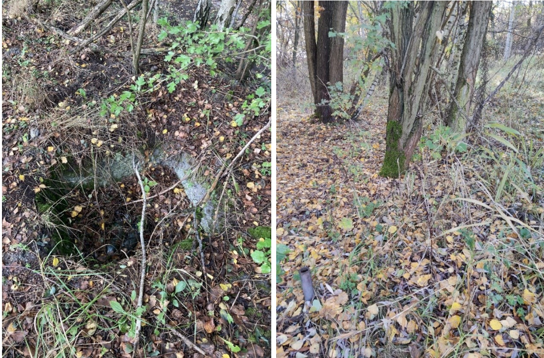
Fot. 3.8. Prostokątne doły nieznanego przeznaczenia znajdujące się wzdłuż drogi dojazdowej do składowiska gipsów i popiołów (zdjęcie po lewej) oraz pozostałości po ogrodzeniu terenu składowiska odpadów poprodukcyjnych, w tym niebezpiecznych (kwatery I i planowana kwatera II) (zdjęcie po prawej).
