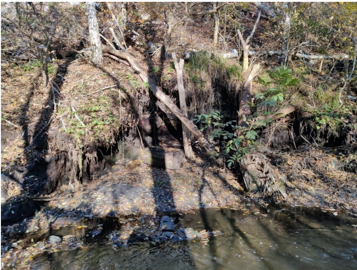
Fot. 3.48. Podmyta skarpa od strony rzeki Bzury (lokalizacja C na Fot. 3.49 ).
